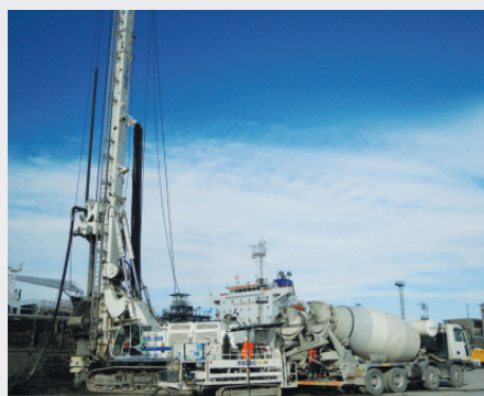
Construction d'une barrière imperméable à l'aide de pieux sécants/CSP (cased secant piles). Pose de béton plastique à base de Solidur® Erdbeton
